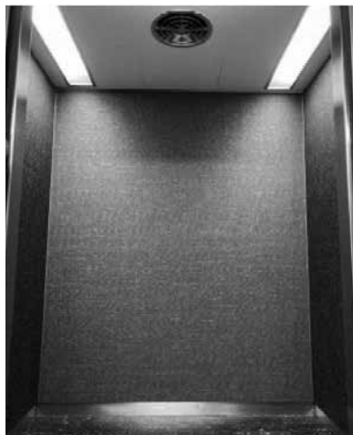
図6 改修後 従業員エレベーターかご内
