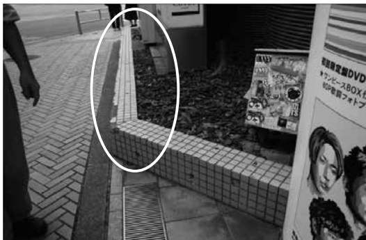
図3 改修前 花壇の腰壁
