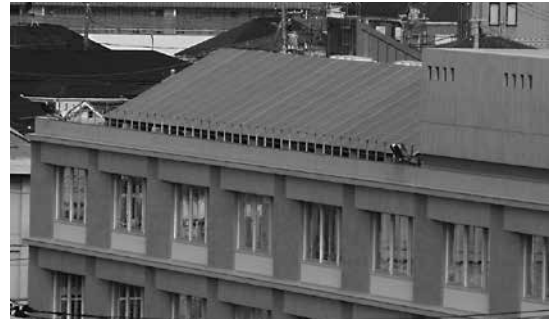
区立城山小学校に設置された太陽光パネル
